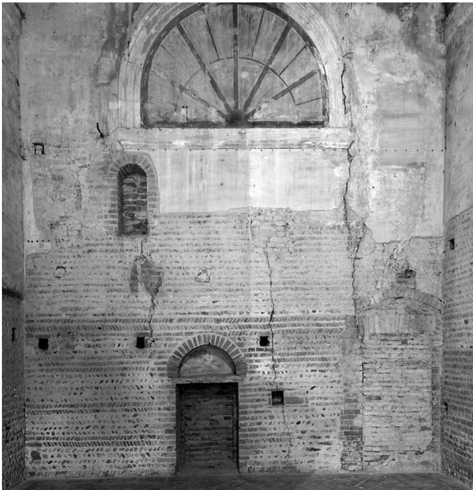
6. Testata del braccio di transetto nord. Il quadro fessurativo è forse da imputare alle aperture in rottura.
