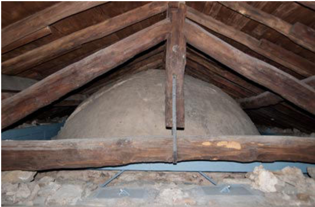
44. Barzanò, San Salvatore. L'estradosso della calotta in conglomerato, già rinforzata da catene lignee in quadrato alloggiate nei rin fianchi, e da due «frenelli» (sorte di contrafforti in muratura) sui lati nord e sud (maggio 2008).
