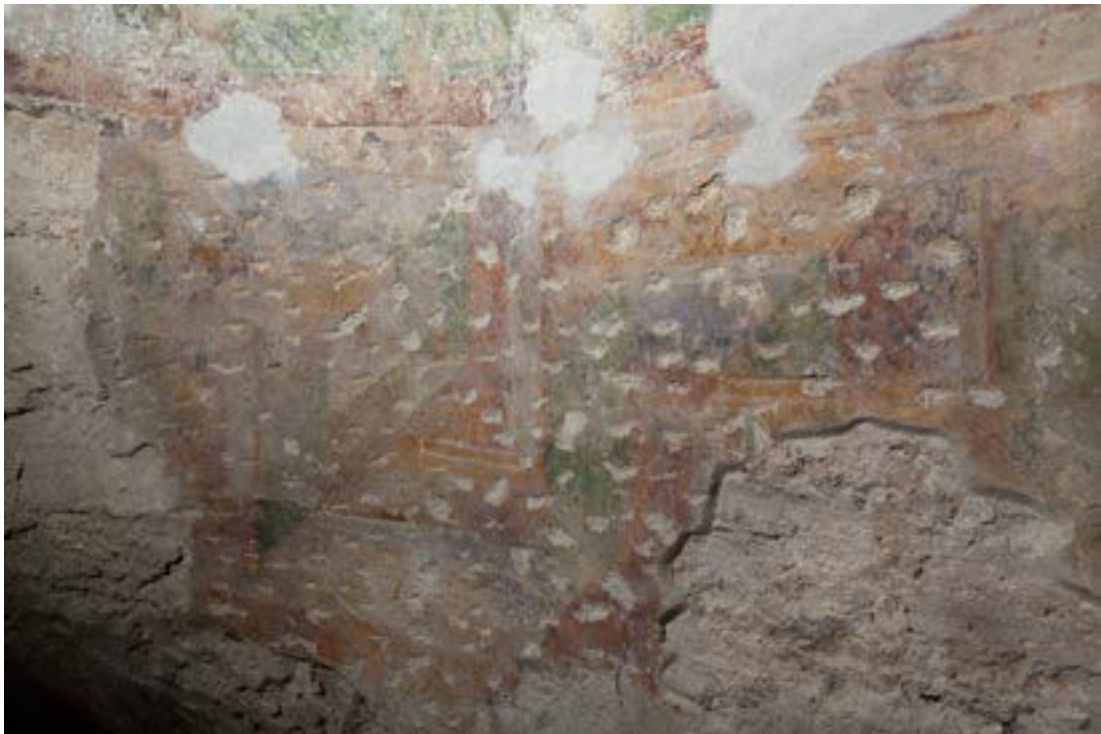
101. Barzanò, San Salvatore. Struttura cupolata, base della calotta, meandro a P assonometrico e policromo (ottobre 2009, dal ponteggio di restauro).
