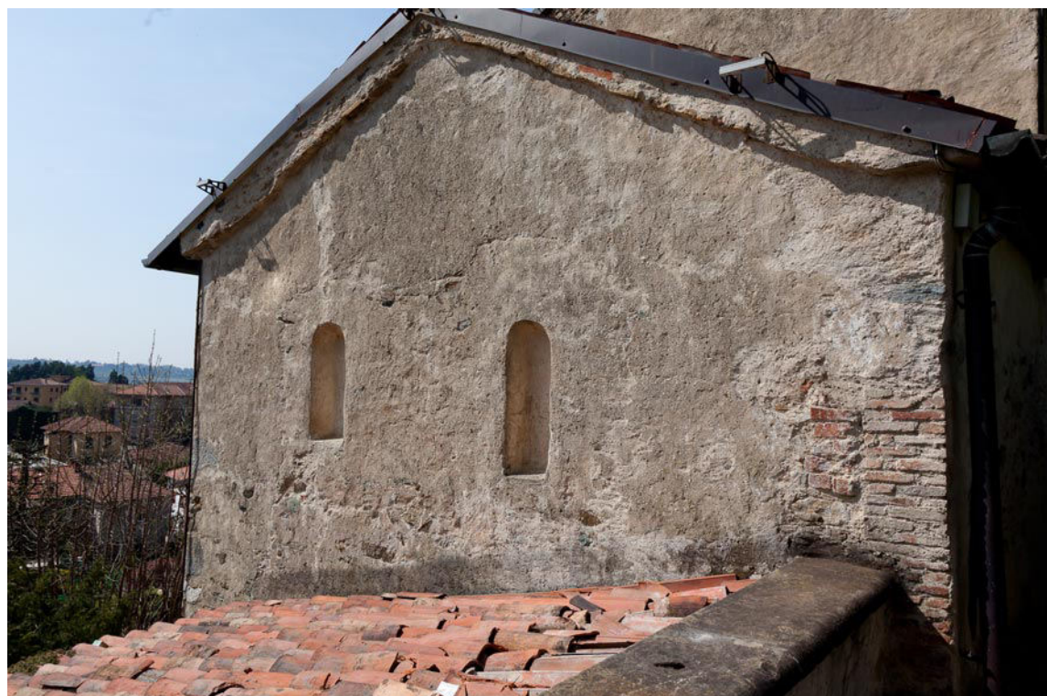
X. La testata del vano presbiteriale voltato. La luce semi-radente evidenzia il rattoppo murario che include le due monofore, occluse prima del 1571 (aprile 2014).
