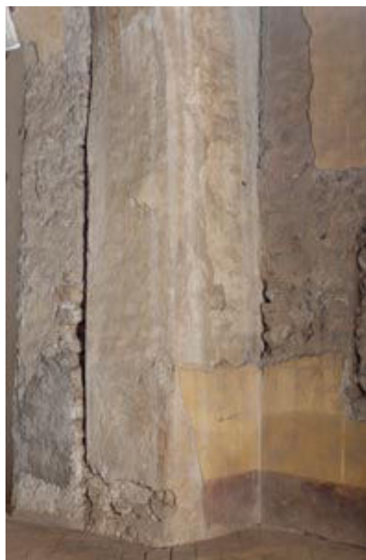
14. Barzanò, San Salvatore. Angolo sudest della campata occidentale. In evidenza, la mancata immorsatura fra il piedritto dell'arcata (già facciata di Fase 1, al centro), il perimetrale sud (Fase 2b, a destra) e il pilastro della struttura cupolata (Fase 3, a sinistra) (maggio 2008).
