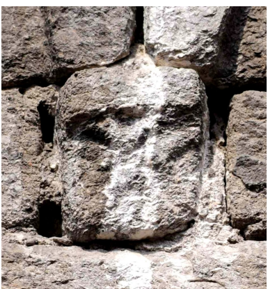
estS5p fianco Sud, campata verso Ovest, sottogronda, ottavo peduccio da sinistra peduccio geometrico 15 ca. x 15 ca. calcare Il peduccio quadrato con listello superiore liscio è decorato da due scanalature incrociate che determinano una X. Conservazione buona.
