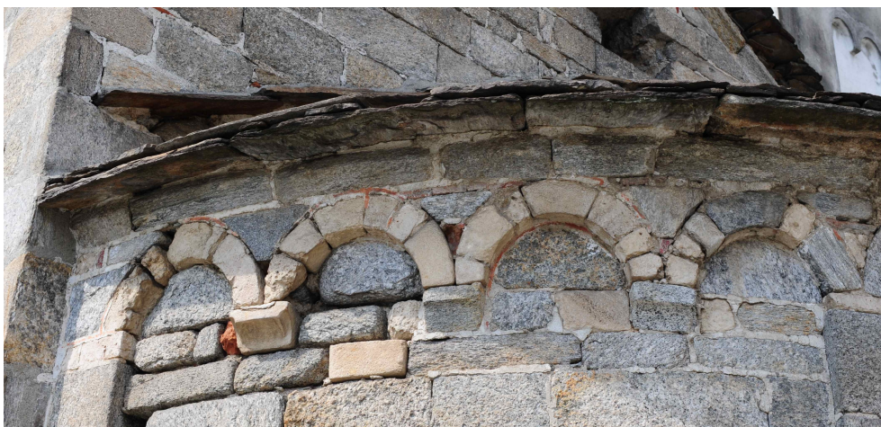
Santa Maria della Natività e Sant'Anna, abside da Sud, sottogronda
