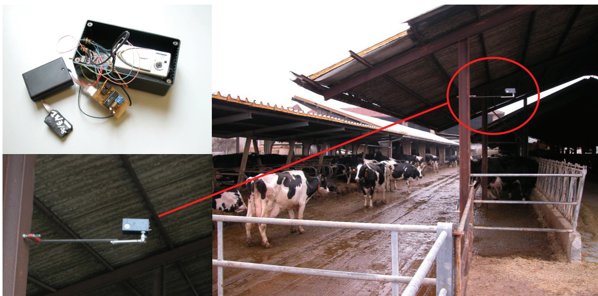
Figura 3.6. Fotocamera temporizzata con esempio di installazione in una struttura stabulativa.
