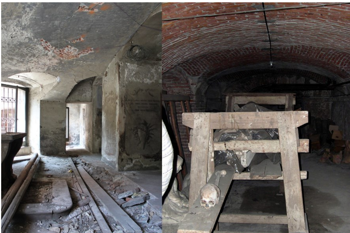
Figura 2 Lo stato della Cripta della Beata Vergine Annunziata prima dei lavori di restauro. Foto scattate da M. Carlessi e A. Kluzer
