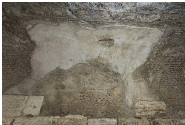
Fig.4. Colosseo, galleria intermedia. Intonaco di colore bianco a rivestimento della volta.
