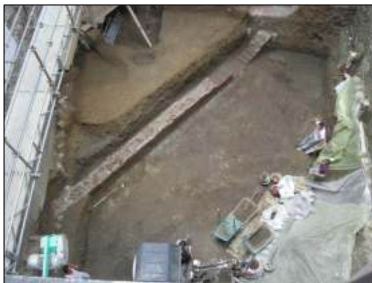
133. Corso di Porta Romana 20, il muro di contenimento (Relazione Tecnica).
