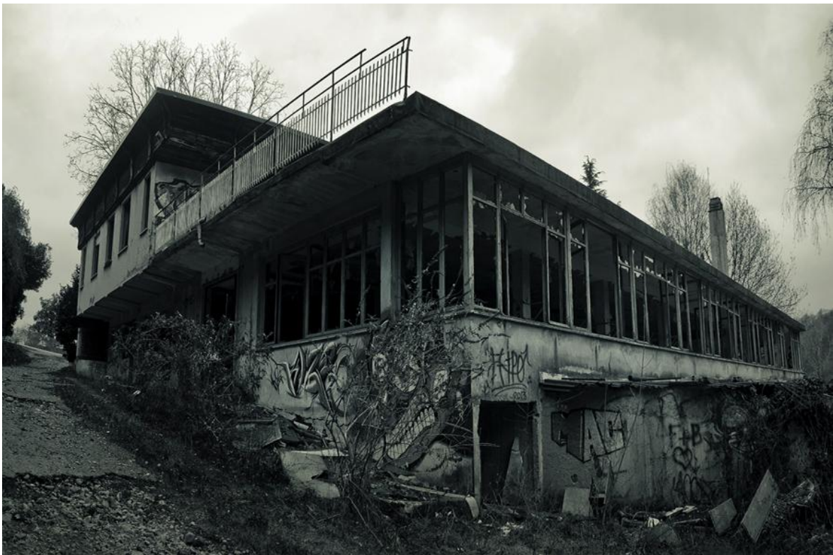
Consonno - Olginate, la situazione attuale della ex casa di riposo (fonte oltreconsonno.it - foto di M. Parini).
