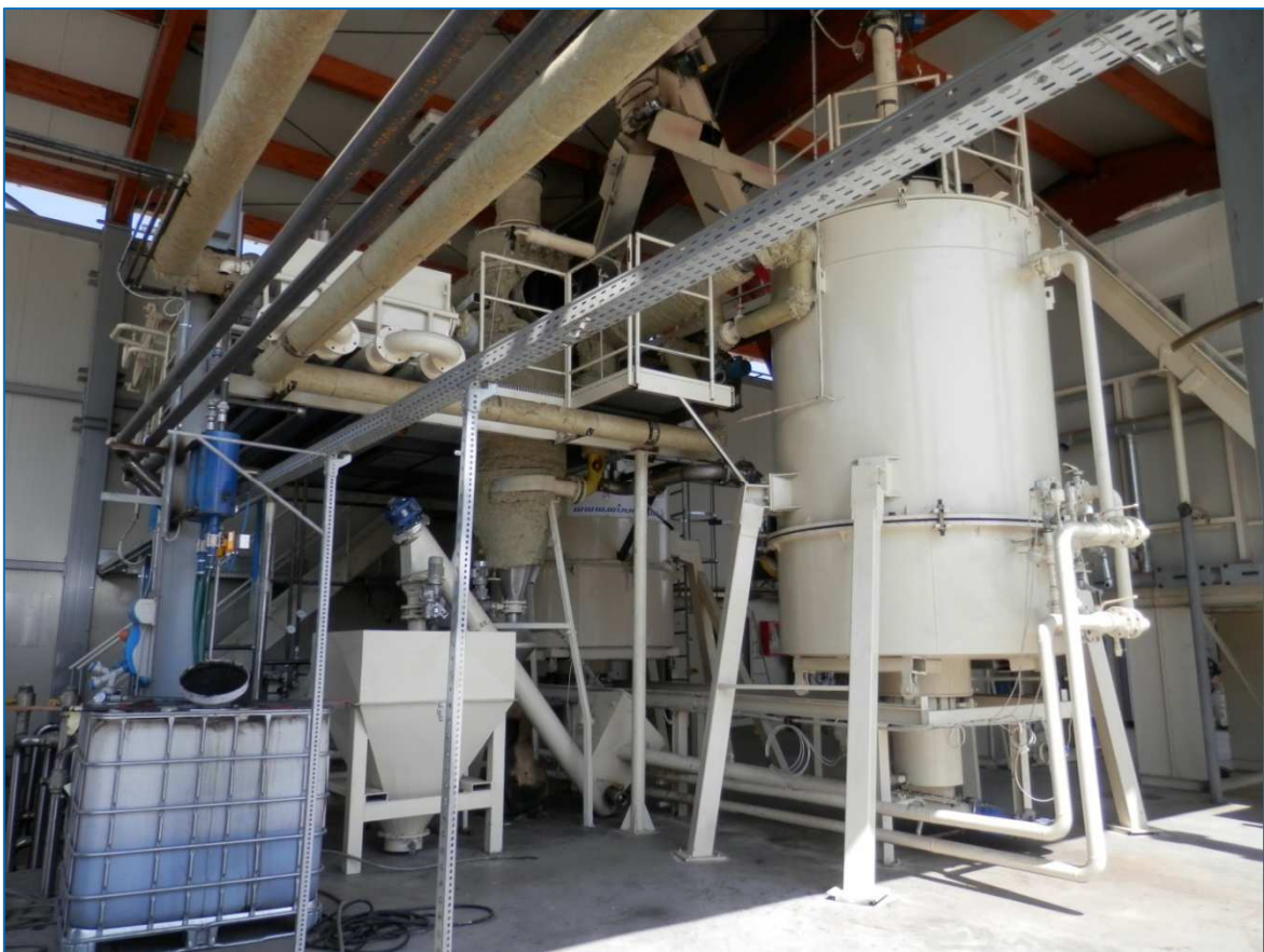
Fig. 1 - Impianto di gassificazione a letto fluido , Azienda Agrindustria s.n.c. di Cuneo
