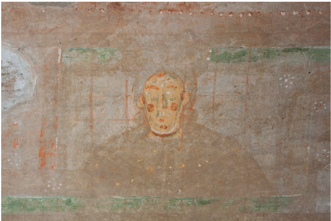
80-81. Dettagli di Elia e del soprastante sacerdote del Tempio con copricapo a turbante (ne resta traccia in negativo per la caduta del pigmento) e pettorale gemmato.
