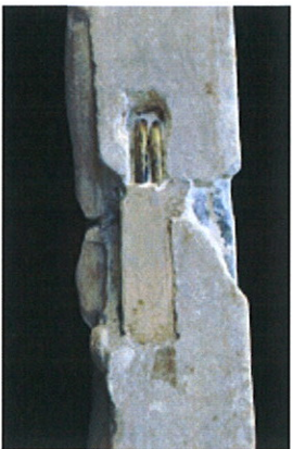
Prima del restauro, particolare delle grappe metalliche inserite nel restauro precedente
