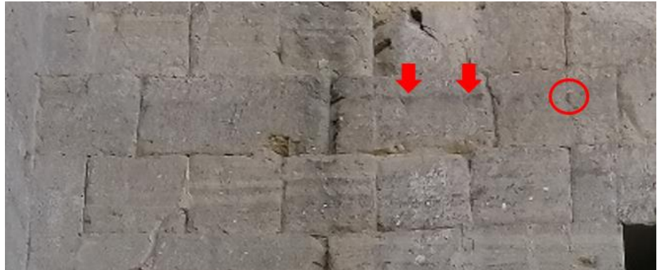
Fig. II.54 Muro di fondo del portico sud. In evidenza il foro per grappa riferibile al fissaggio dei fregi e la porzione del muro incassata
