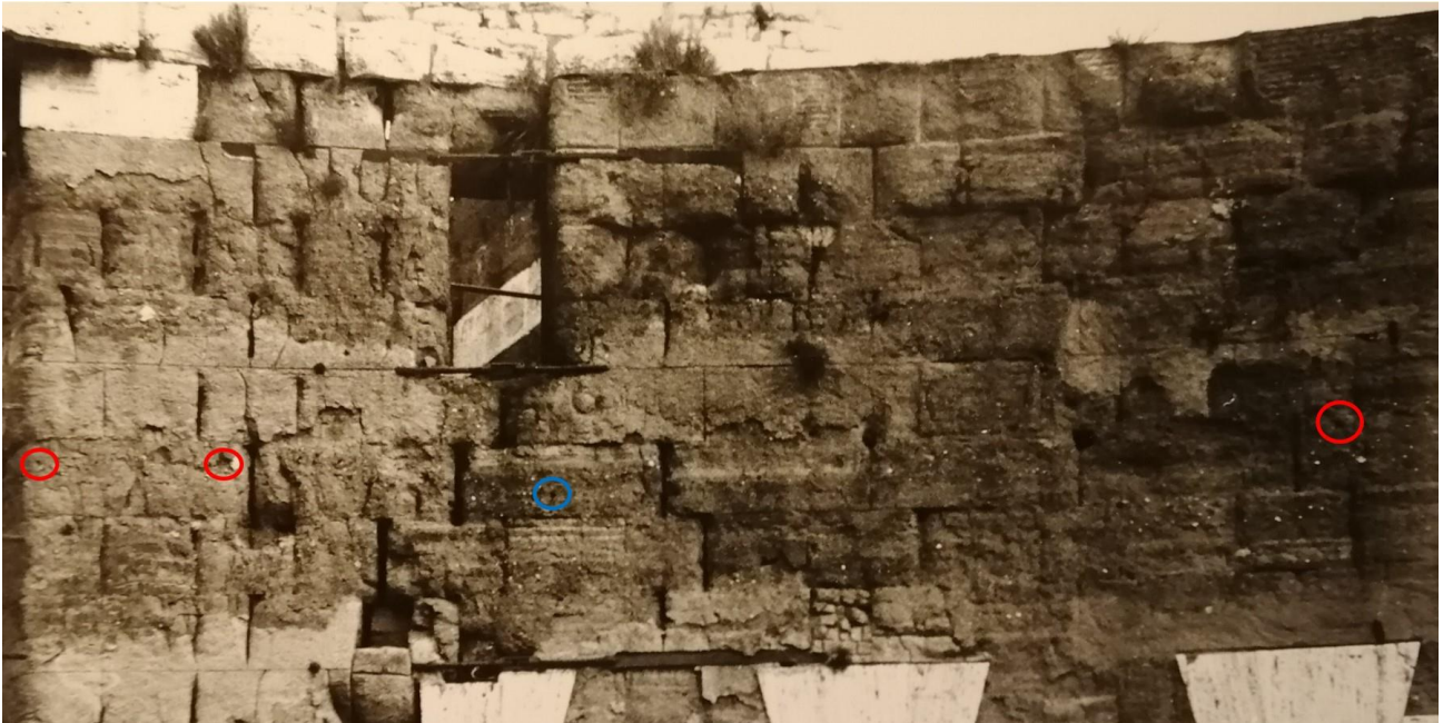
Fig. II.102 Foto di archivio di Bauer dell'esedra sud. In evidenza i fori per grappa attribuibili agli architravi (in rosso) e un incavo di dubbia interpretazione (in blu)
