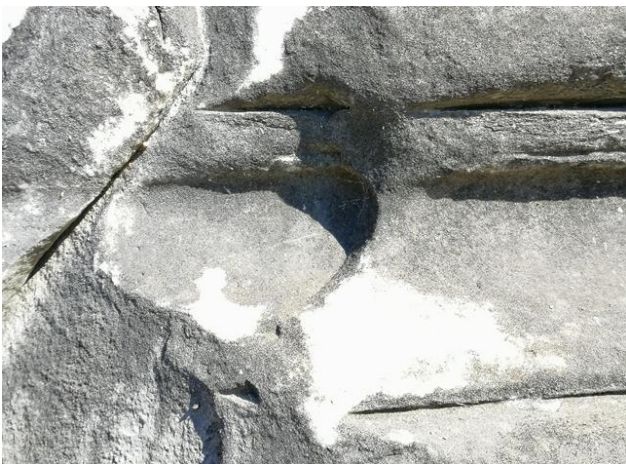
Fig. II.46 Fianco sinistro della base in post. Il particolare del passaggio tra la porzione rettilinea e curvilinea.
