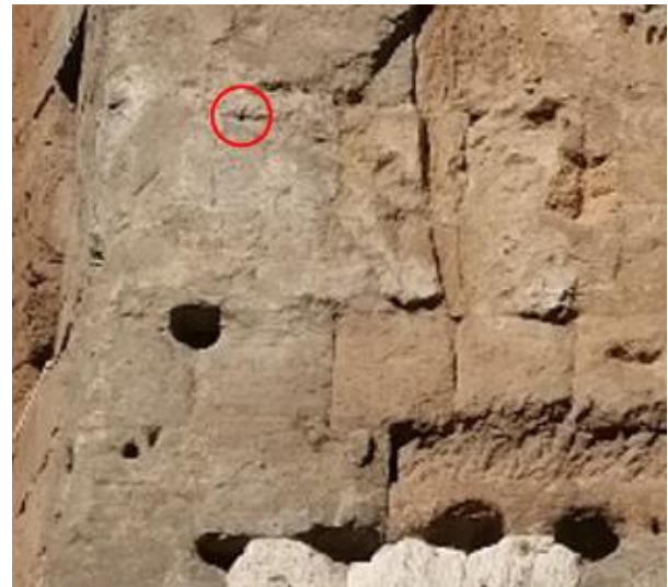
Fig. II.43 Muro di fondo del portico nord. In evidenza il foro per grappa riferibile al fissaggio degli architravi
