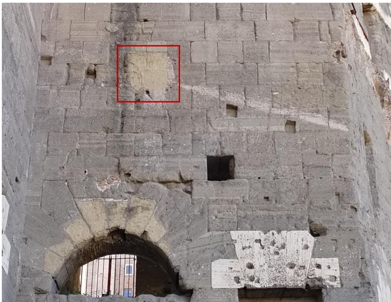
Fig. II.115 Muro di fondo del portico sud. In evidenza l'apertura tamponata in blocchi di tufo di Grotta Oscura
