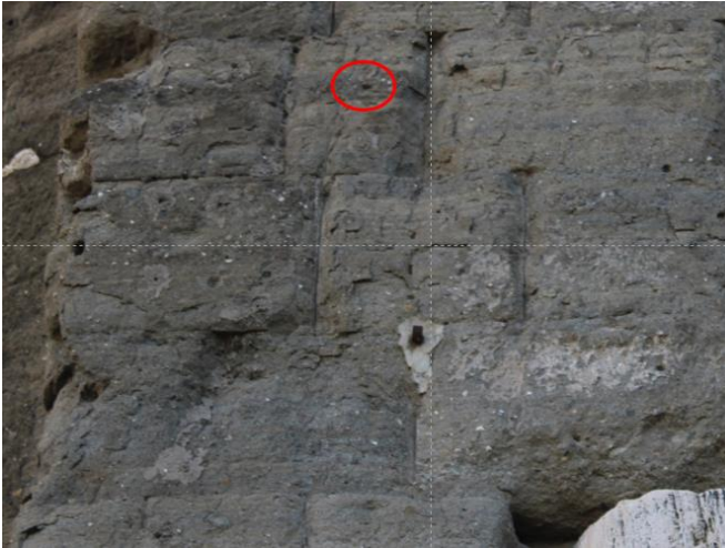
Fig. II.21 Muro di testata del portico, segmento tra l'angolo verso la piazza e la prima piattabanda. In evidenza il foro per grappa attribuibile al capitello
