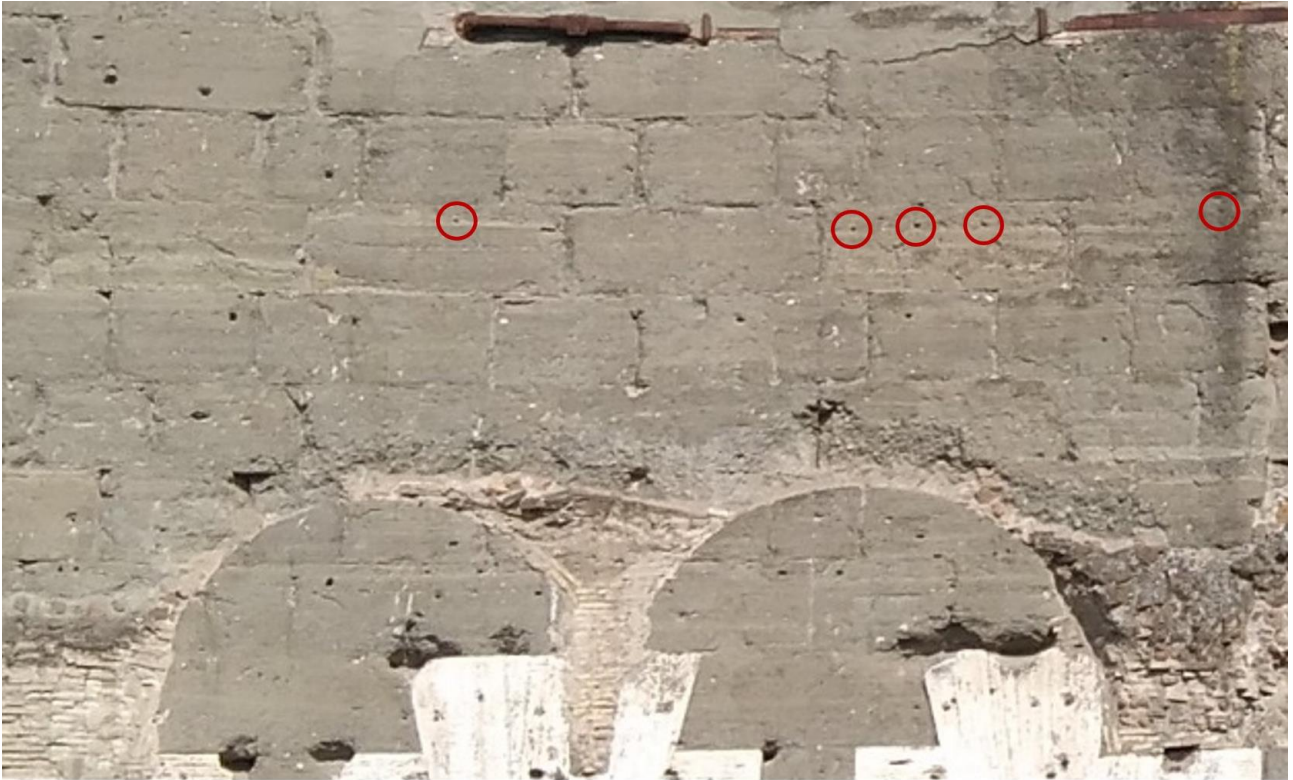
Fig. II.57 Esedra sud. In evidenza i fori per grappa riferibili al fissaggio dei fregi
