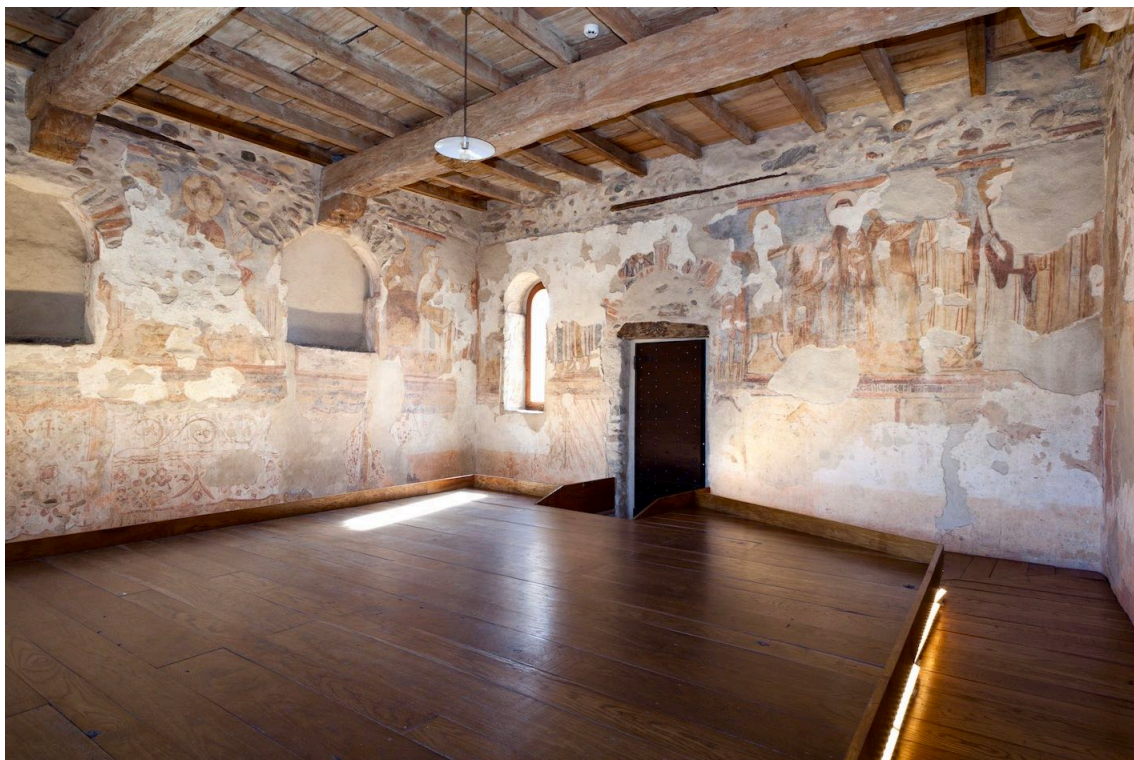
12 Torre, terzo livello, pareti est e sud, con l'accesso a quota 276,73 m (foto dell'Autore, 2017)
