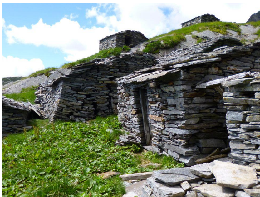
Fig. 8.1 – Baite abbandonate ad Avert di Mezzo, alta Val Pesciadello. Le lesioni e l'inclinazione dei muri sono provocate dalla fusione stagionale di permafrost. L'abbandono delle baite, e quindi la mancata manutenzione, ha permesso al fenomeno di agire per lungo tempo e permettendo il danneggiamento. Queste baite sono un esempio dei pericoli a cui possono andare incontro edifici o manufatti in genere costruiti su terreni interessati da permafrost.
