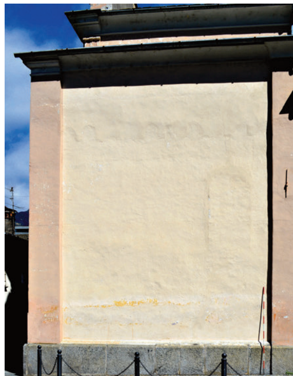
Fig. 15. Mazzo di Valtellina, Santo Stefano. Fianco sud: sotto l'intonaco si intravedono i profili della monofora e degli archetti sottogronda romanici (foto di Alessandro D'Alfonso, rielaborata).
