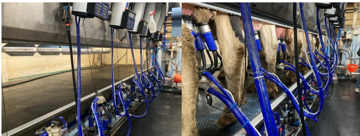
Figura 6. La progettazione illuminotecnica integrata con DIALux® Evo ha permesso di simulare e analizzare con precisione come la luce si comporta sulle poste di mungitura. In questo modo è stato possibile realizzare un impianto di illuminazione molto efficiente, conforme alla norma UNI EN 12464-1:2021, che garantisce una visione chiara di mammella, capezzoli, gruppi di mungitura e pavimentazione, migliorando la percezione spaziale e assicurando un comfort visivo ottimale. Ciò consente l'esecuzione efficace delle routine pre- e post-mungitura.
